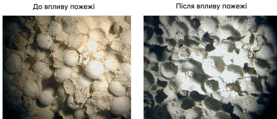
Рисунок 1 – Вигляд вогнезахисного штукатурного покриття до та після впливу пожежі
