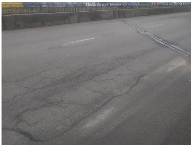
Рисунок 1 - Дефект мостового полотна. Руйнування з появою тріщин
