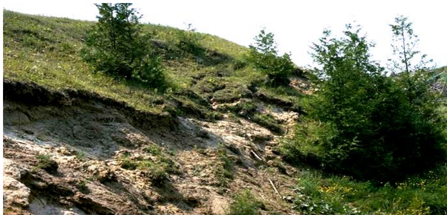
Рисунок 1 – Руйнування земляного полотна
