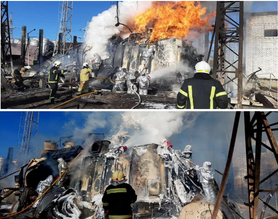
Рис. 2.7. Гасіння пожежі у групі трансформаторів внаслідок обстрілів
