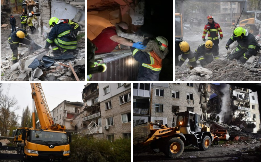
Рис. 2.10. Проведення пошукових та АРР на зруйнованих будівлях
