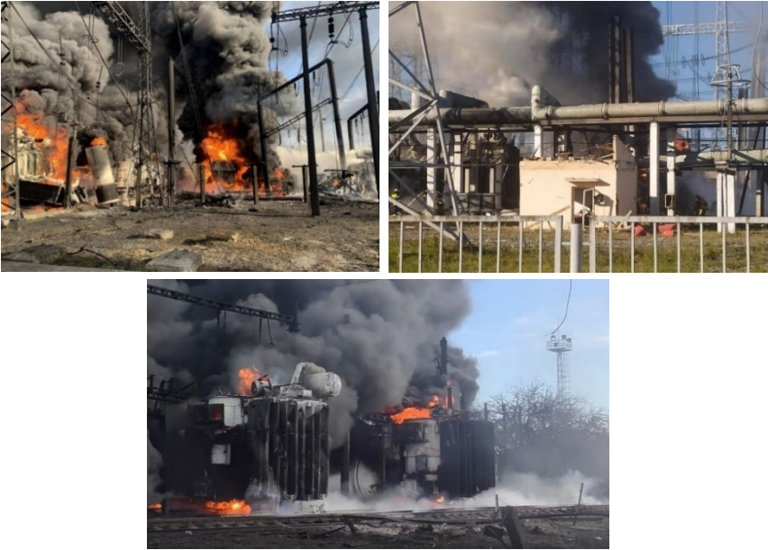
Рис. 2.6. Обстановка на пожежі
