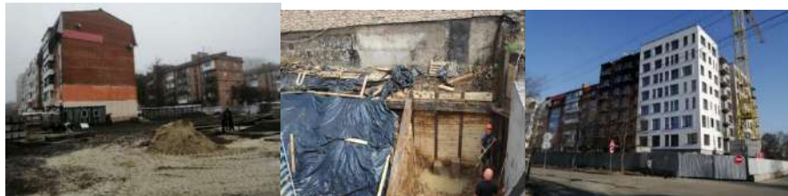
Рис. 2. Майданчик до відкопування котловану (а), монтаж підкосу між обв'язувальною балкою та новим ростверком (б), сучасний вигляд майданчику (в).
