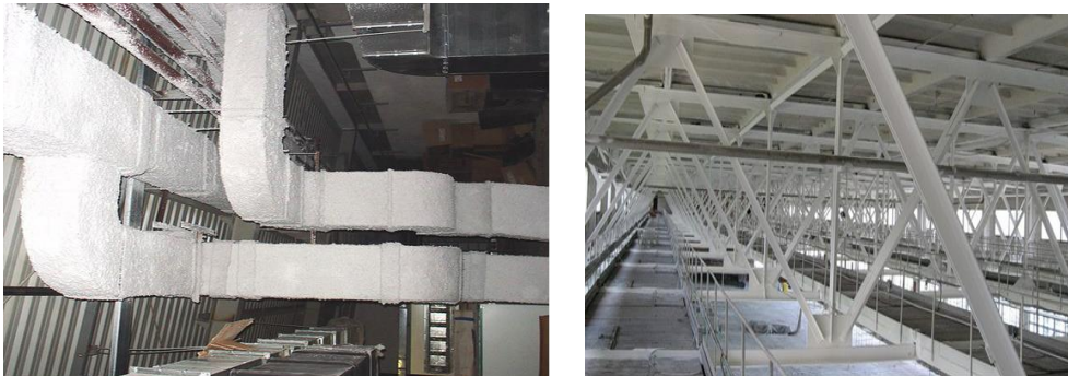
Рис.1 Повітропровід та несучі конструкції будівлі з межею вогнестійкості
