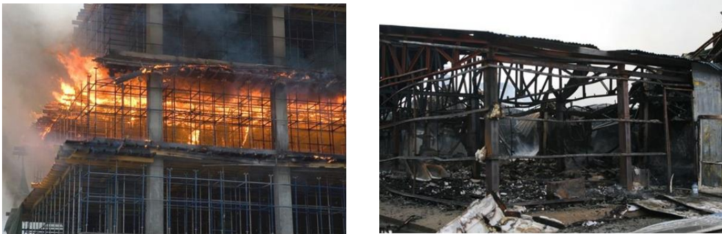
Рис.1. Вплив вогню на будівельні конструкції та результат (їх деформація)
