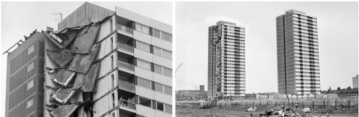
Рис. 1. 16 травня 1968 рік, Лондон, наслідки ефекту прогресуючого обвалення конструкцій житлового будинку після вибуху побутового газу в одній із квартир
