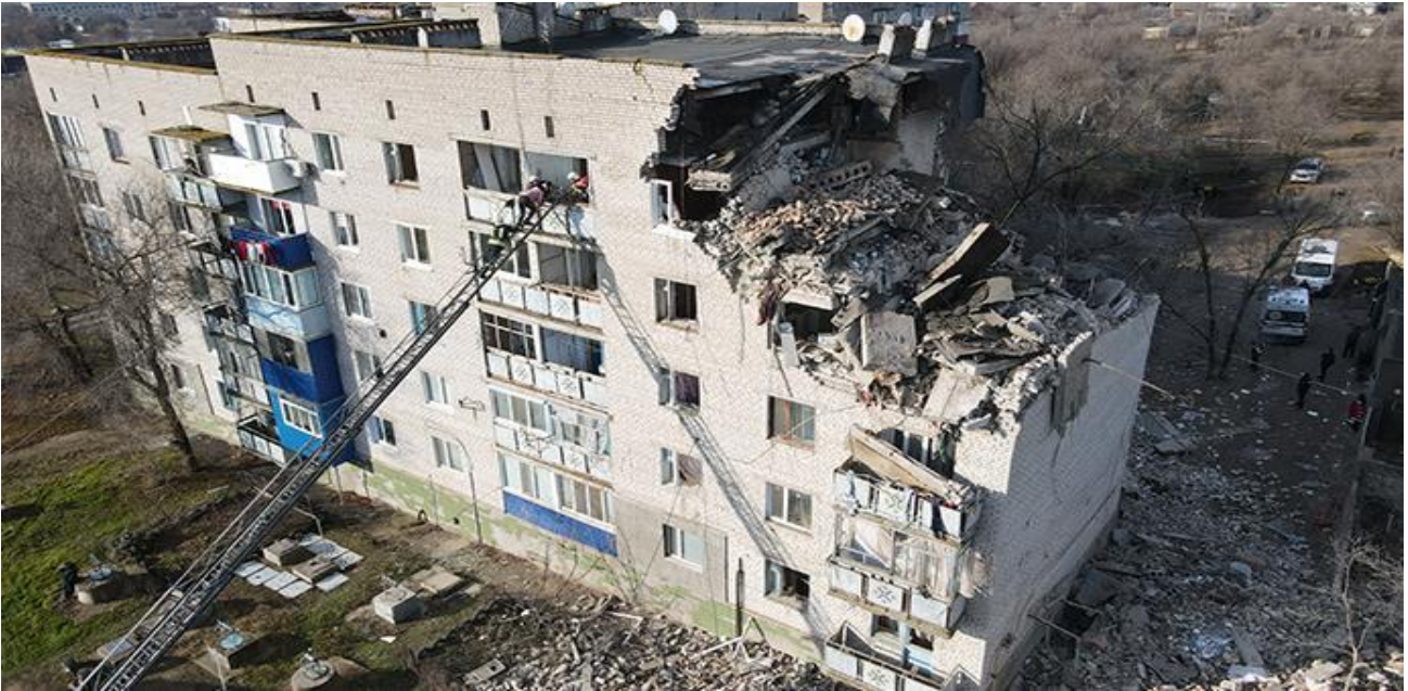
Рис. 4. Руйнування будинку внаслідок вибуху газу
