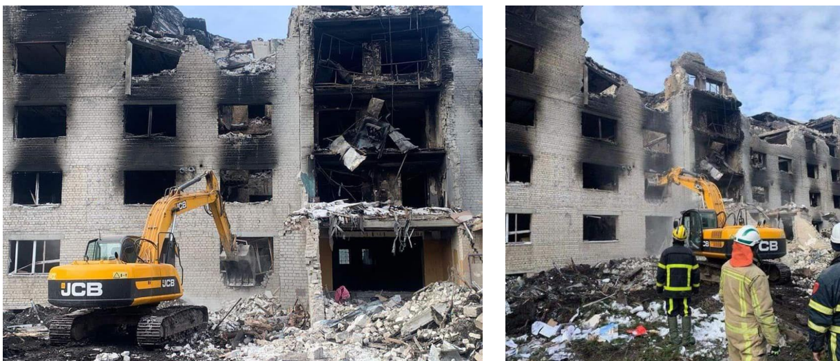
Рис 1. Гуртожиток Харківського національного університету ПС ім. Івана Кожедуба після ракетно-бомбового удару збройними силами РФ (березень 2022 року)
