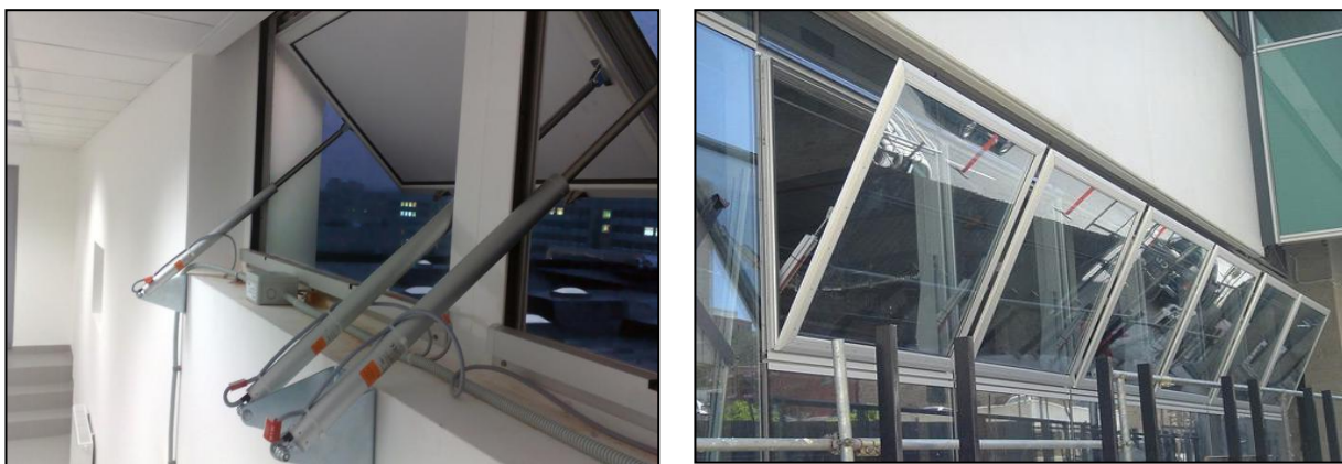
Рис. 3.5 – Вентиляційні пристрої систем природного димо- та тепловидалення
