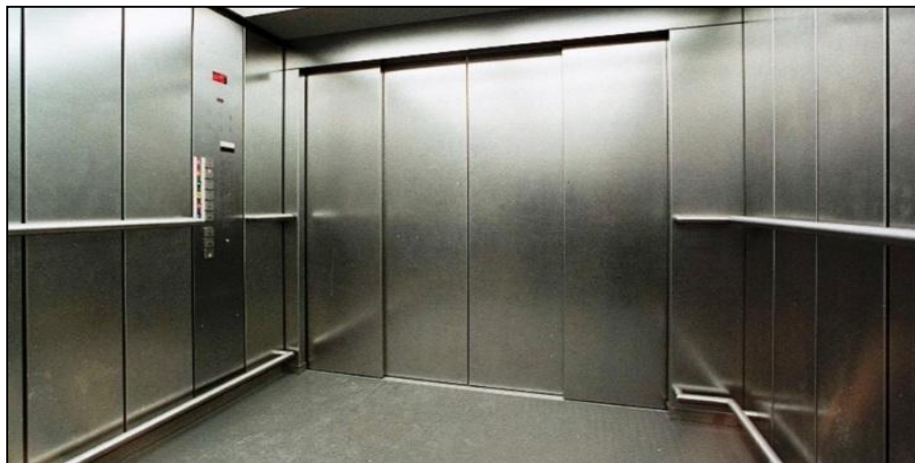
Рис. 6.6 – Внутрішній вигляд пожежного ліфта
