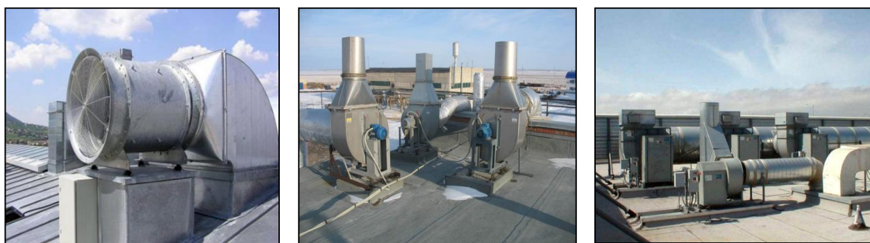
Рис. 3.11 – Вентилятори систем механічного димо- та тепловидалення
