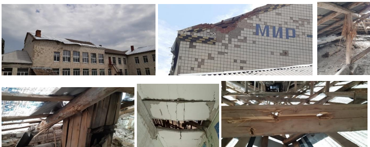
Фото 1. – Загальний вигляд руйнувань будинку (руйнування покрівлі, пошкодження цегляної кладки стіни, дерев'яних елементів кроквяної системи покрівлі, руйнування залізобетонних плит горіщного перекриття)
