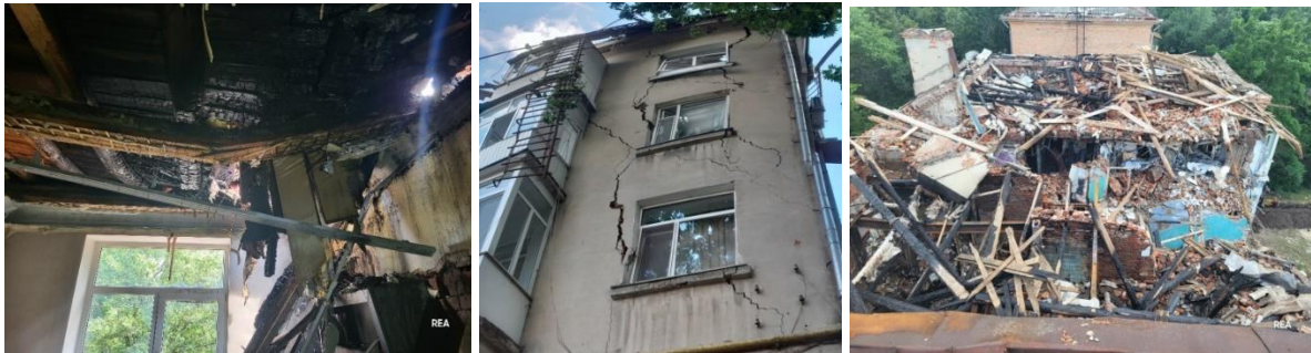
Фото 2. – Руйнування та пошкодження конструктивних елементів будівлі внаслідок вибуху та пожежі
