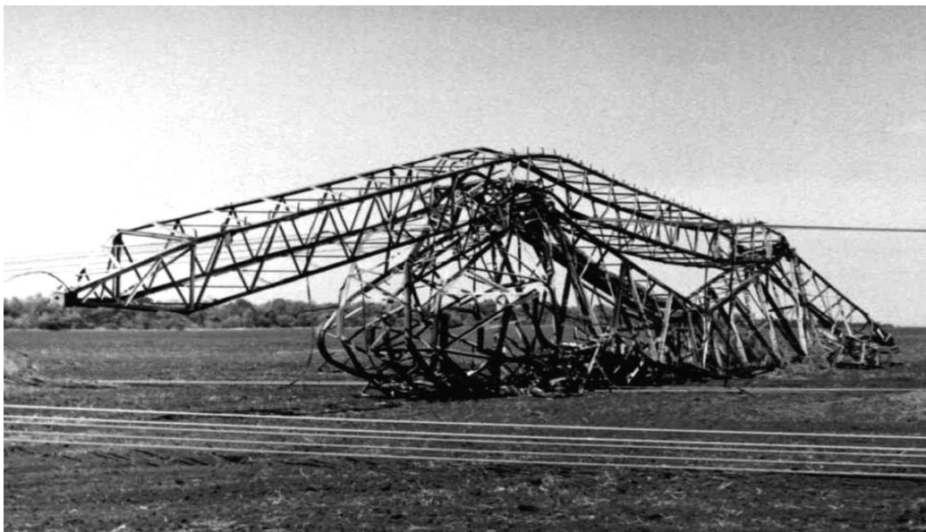
Рисунок 3.4 – Руйнування інженерної споруди від ожеледі
