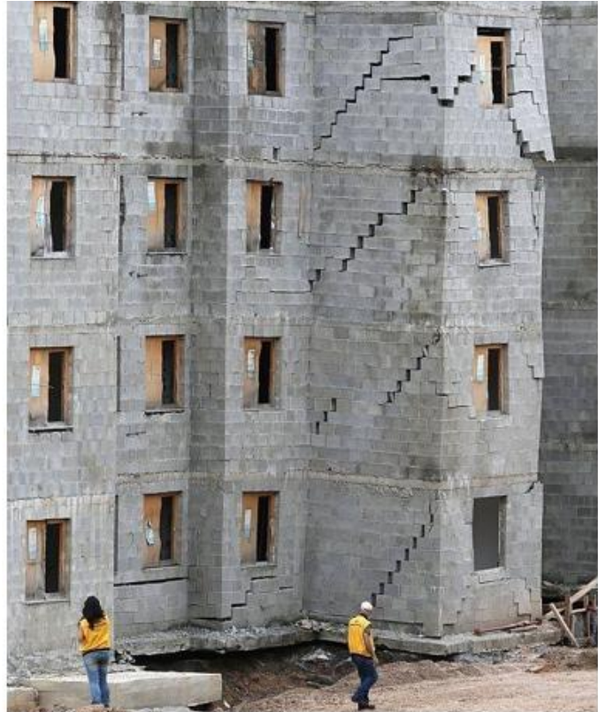
Рисунок 1.10 – Недооцінка стану системи «будівля-основа»
