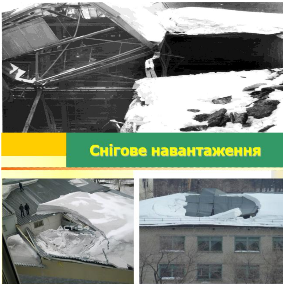
Рисунок 3.1 – Руйнування конструкцій покриття від снігового навантаження
