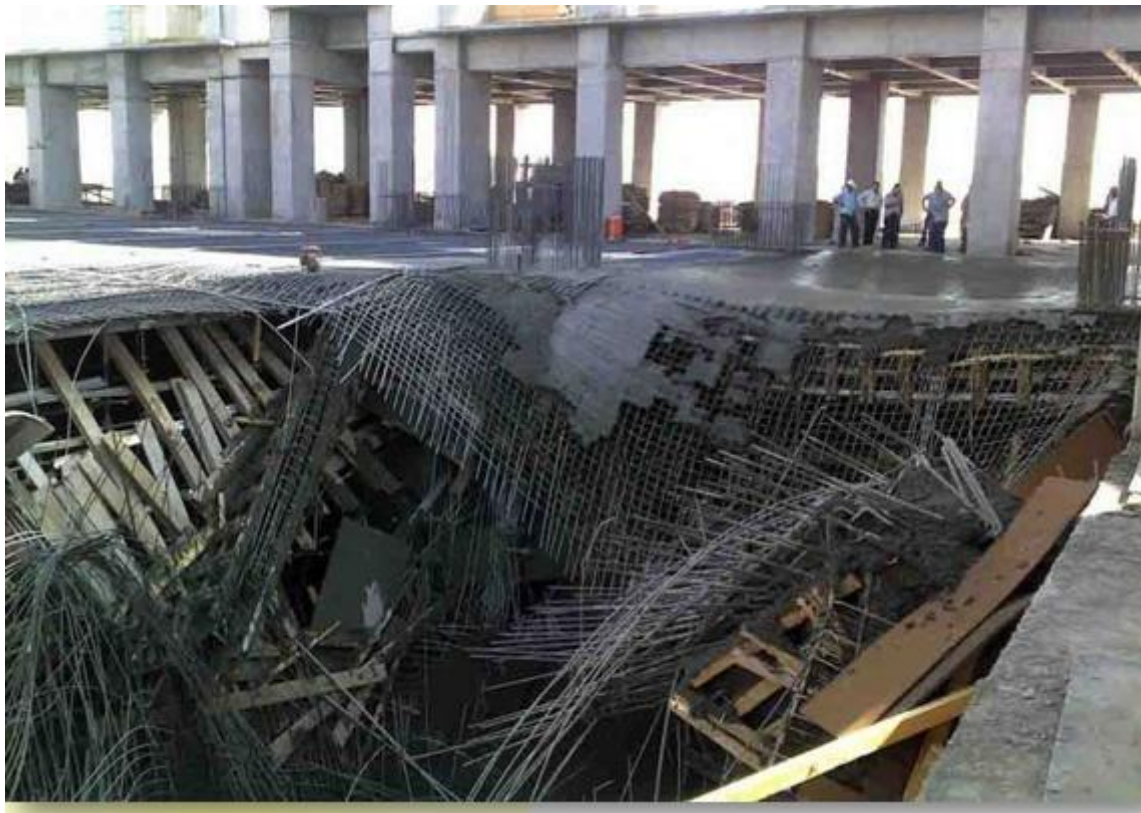
Рисунок 1.8 – Руйнування монолітного перекриття
