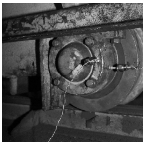
Рис. 2. Встановлення сенсорів реєстрації шуму і вібрації на буксу ходового колеса візка мостового крана
