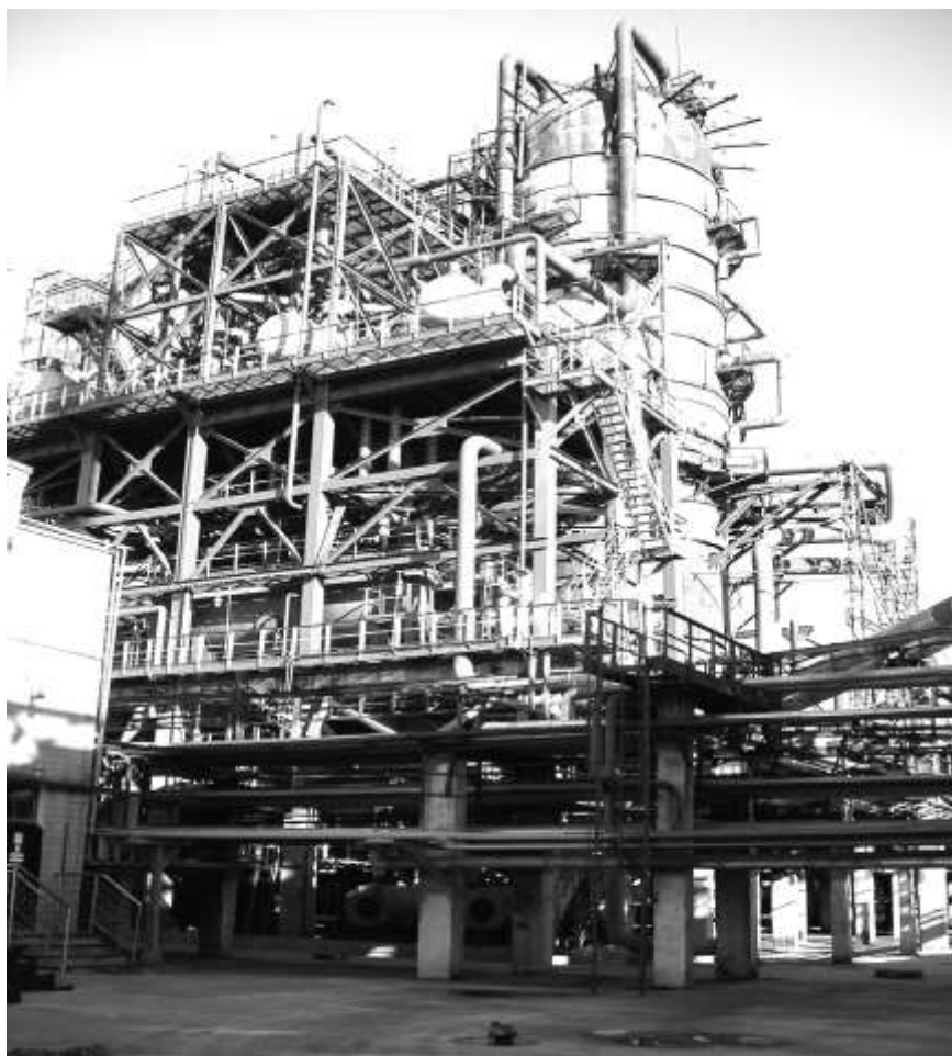
Рис. 2.11 —Обладнання для створення вакууму. У верхній частині видно 2 ежектори, до яких зверху колони надходить пара
