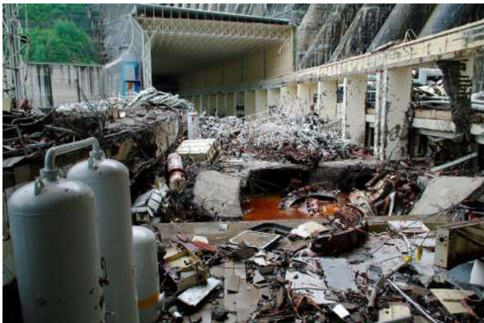
Рис. 4.8 — Машинний зал Саяно-Шушенської ГЕС після аварії
