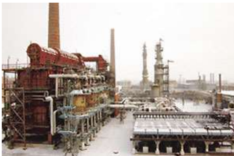
Рис. 2.21 —Установка каталітичного риформінгу з періодичною регенерацією каталізатора: апарати жовтого кольору - реактори; справа на передньому плані – блок повітряних холодильників
