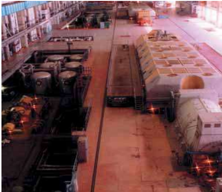
Рис. 4.6 — Загальний вид машинного залу ТЕЦ
