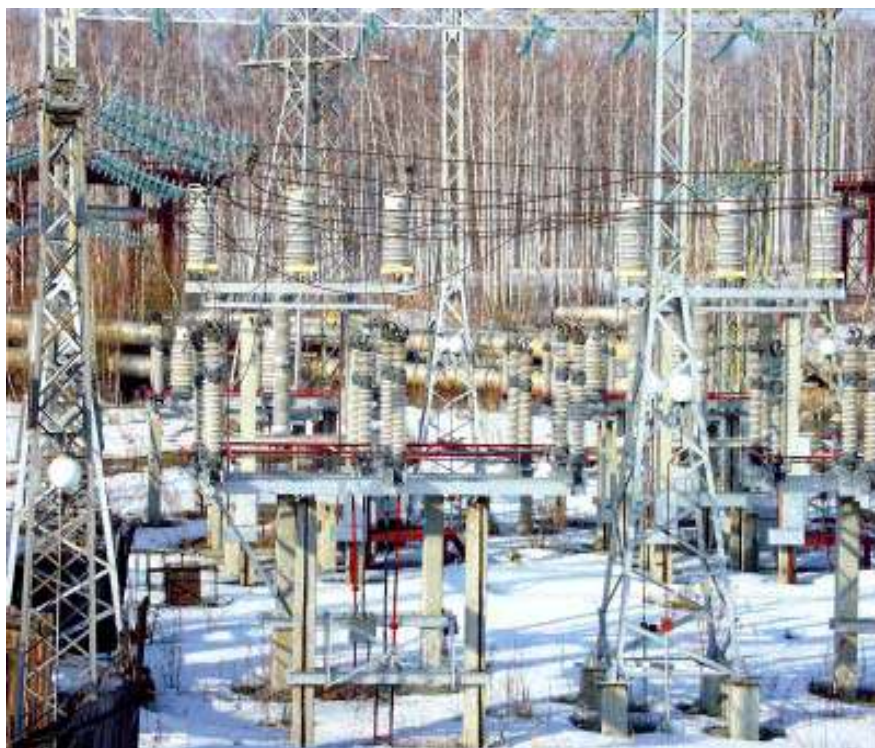
Рис.4.7 —Загальний вигляд відкритого розподільчого пристрою електростанції
