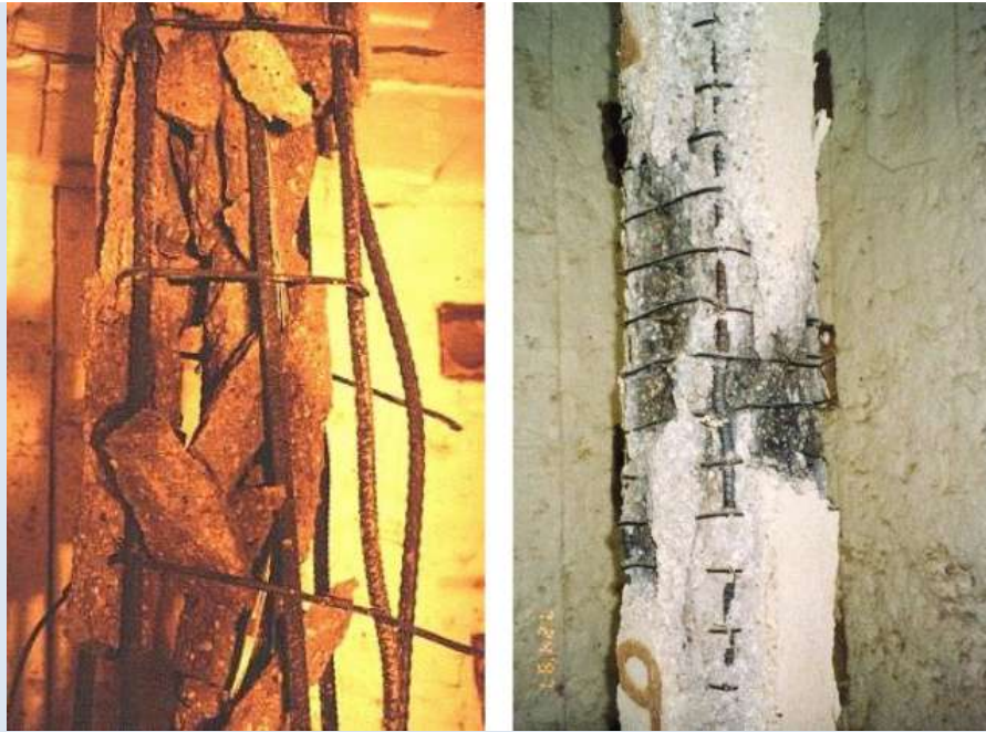
Рисунок 18 – Колони після високотемпературного впливу (вплив поперечної арматури)
